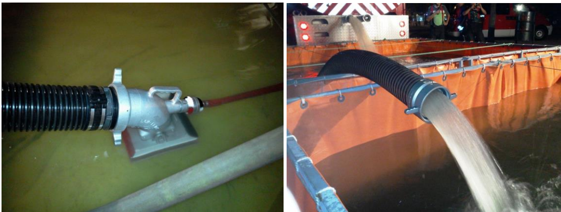
Fig. 4 Sistemas de bajo perfil (a) presurizados para sifones jet, sistemas de trasvasije de agua (b) desde una piscina a otra.
